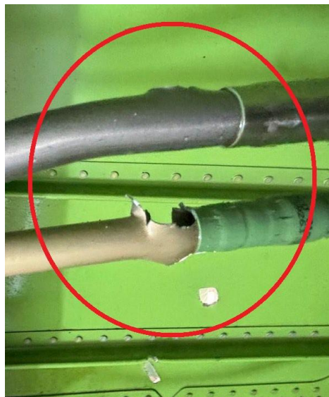
Рис. 14. Гидравлическая система 1 – Поврежденная трубка - детальный вид
