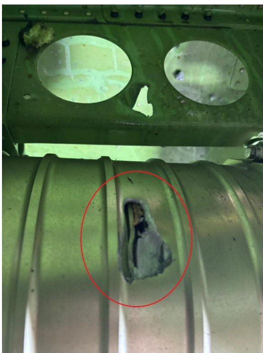
Рис. 18. Гидравлическая система 3 – поврежденный резервуар
