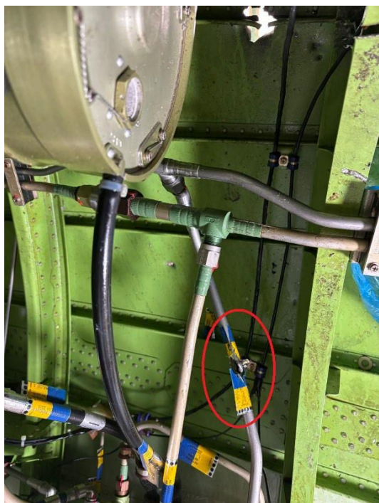
Рис. 15. Гидравлическая система 3 – поврежденная трубка
