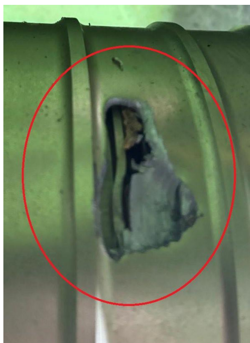
Рис. 19. Гидравлическая система 3 – детальный вид поврежденного резервуара
